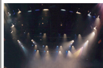
照明、天井バトン
